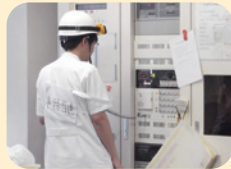
確認現場より火災発生との連絡後全館放送を行う。 (2分以内)
